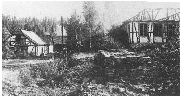
Glasshytta var den første bygningen som ble restaurert og bygningens tilstand var så elendig at den så å si ble revet ned til grunnen. Foto tatt av Cato Enger 1938.
